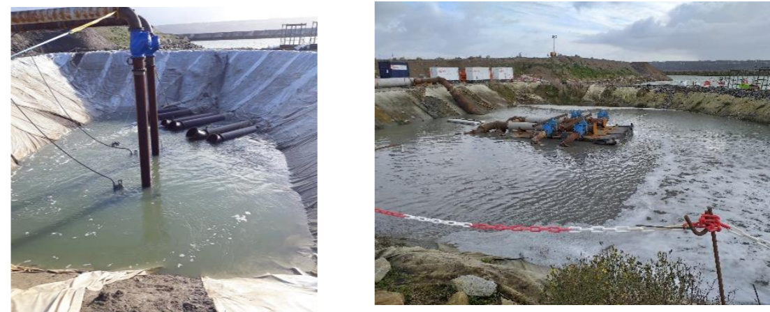
Figure 31 : Exemple de bassin de décantation des rejets
