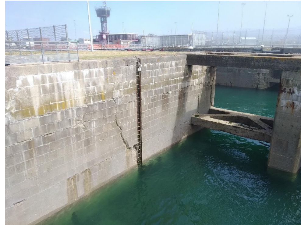
Figure 42 : Fissures au niveau du mur de l'écluse côté embectage Nord
