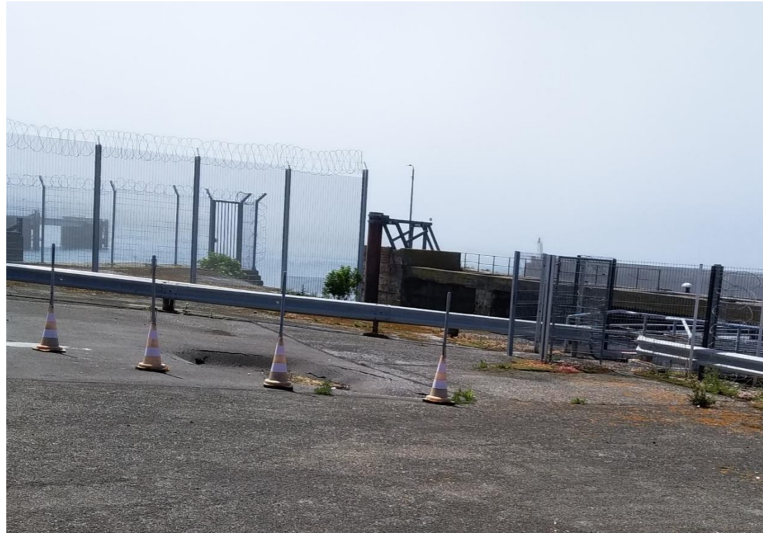
Figure 45 : Affaissement du terre-plein en tête de la jetée sud
