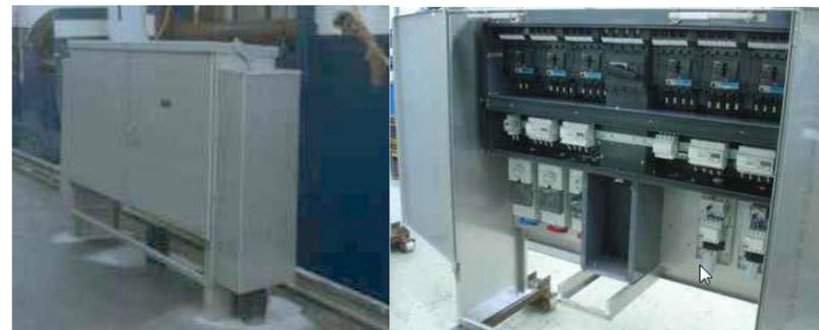
Figure 105 : Raccordements et appareillages à l'intérieur du coffret (Source : Schneider)
