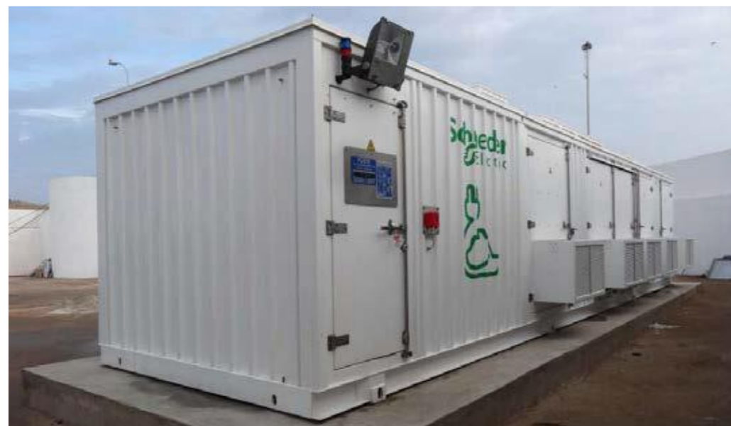
Figure 103 : « Shelters » pré-équipés des équipements HTA (Source : Schneider)
